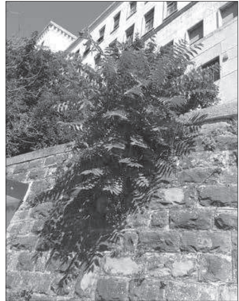
L'Ailanto colonizza facilmente le zone edificate e può provocare danni ai manufatti. Pianta germinata nella fessura della cinta muraria dell'Università di Trieste (Foto Saldaña López Asunción)
